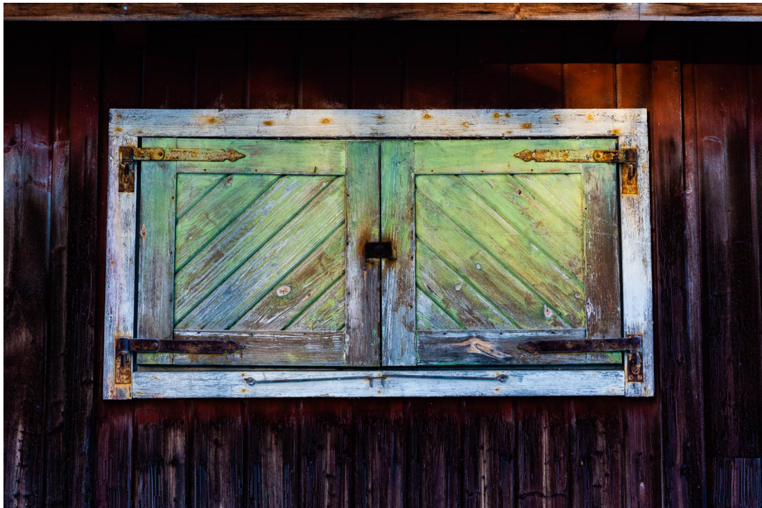
Fönsterluckor med ett visst underhållsbehov
